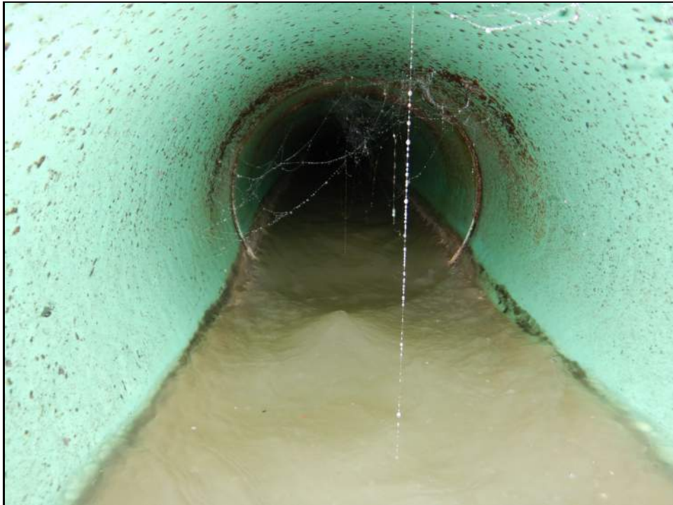
N Influent Pipe
