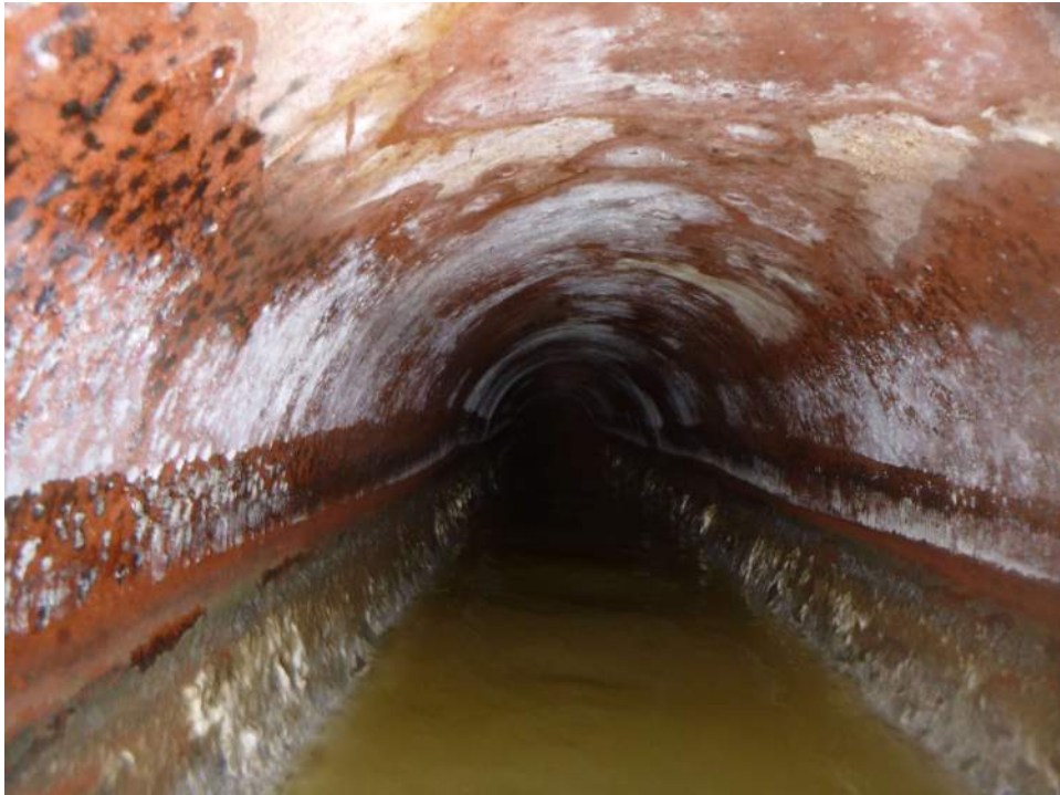
N Influent Pipe
