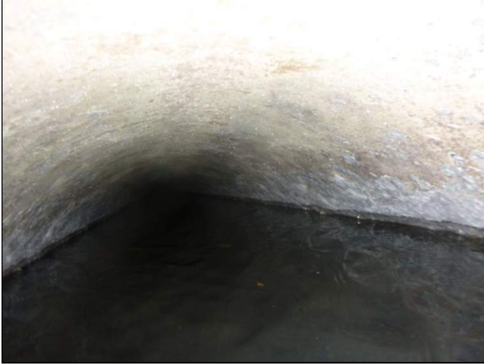
S Influent Pipe
