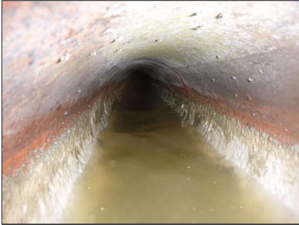
E Influent Pipe
