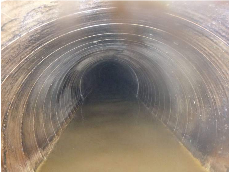
E Influent Pipe
