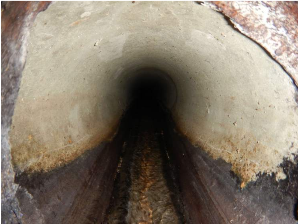
E Influent Pipe
