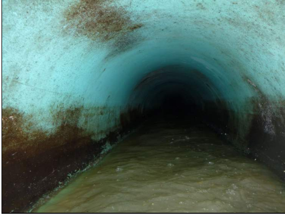
SE Influent Pipe
